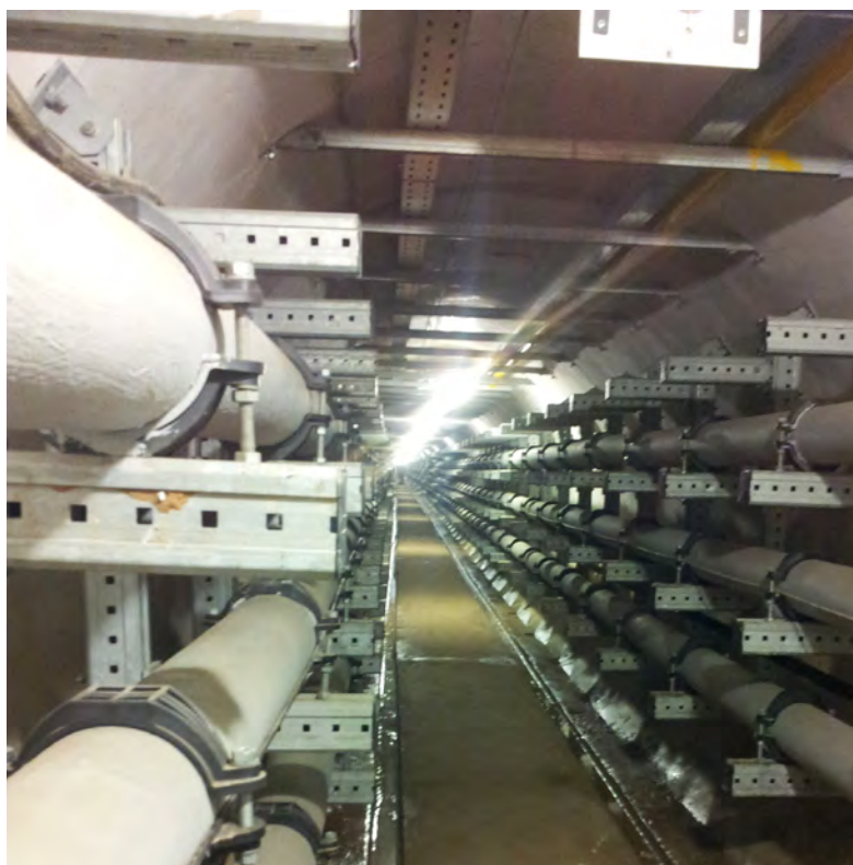
Рис. 32. Кабели 500 кВ в коллекторе, закреплённые через каждый метр на консолях хомутами
