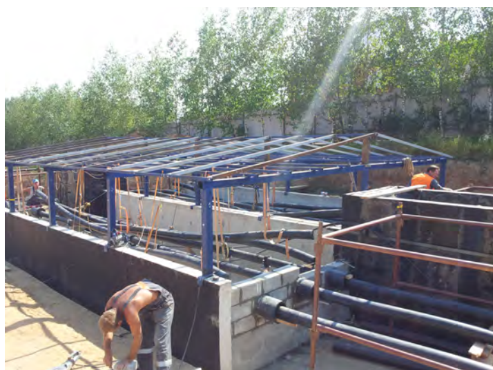
Рис. 26. Колодец для соединительных муфт (с каркасом для защитного тента) с заведёнными в него кабелями 500 кВ
