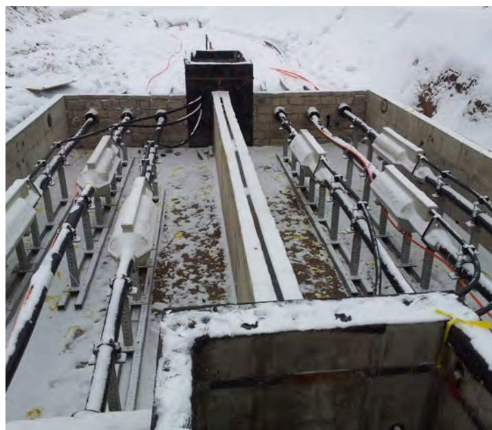
Рис. 29. Соединительные муфты SEHDVCB 550, смонтированные в колодце и закреплённые на металлоконструкциях. Защитный тент с колодца снят
