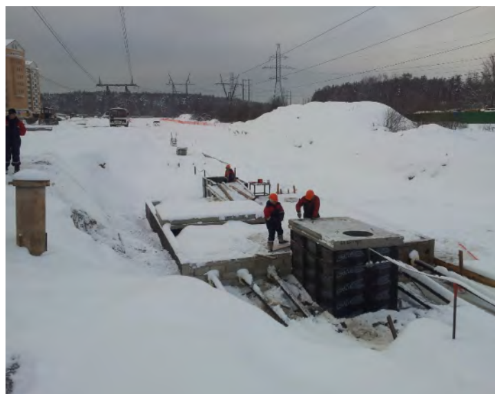
Рис. 30. Колодец со смонтированными соединительными муфтами SEHDVCB 550, засыпанный песком и закрытый железобетонными плитами
