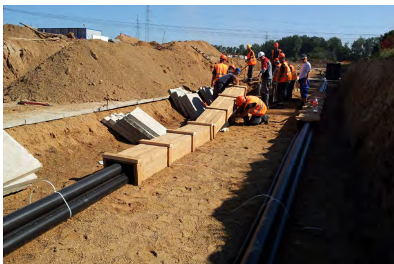
Рис. 24. Кабели 500 кВ, связанные в треугольник вплотную пластиковыми стяжками и закрытые временными деревянными коробами
