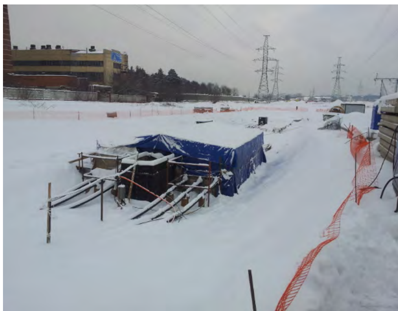
Рис. 27. Колодец для соединительных муфт, закрытый защитным тентом, с заведёнными в него кабелями 500 кВ
